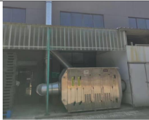
废气处理设施
